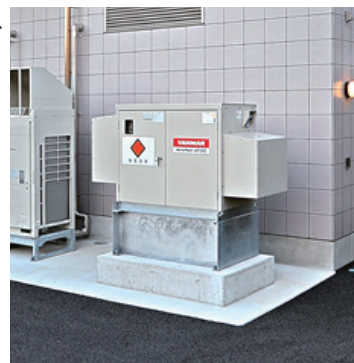
諏訪支店の自動発電設備
