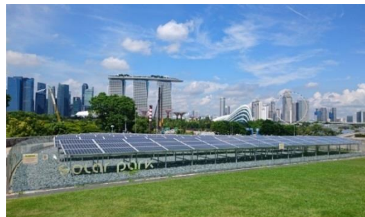
【マリーナ・バラージの太陽光発電パネル】
